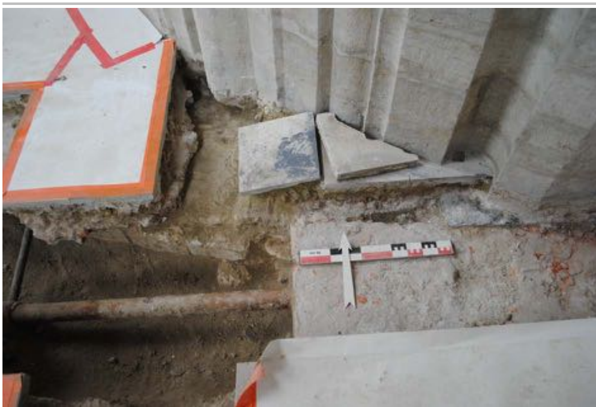
Fig. 4.18: De massieve fundering in cementmortel en baksteenbrokken (S 42) is tegen de fundering (S 43) van de eerste zuidwestzuil aangesmeerd.
